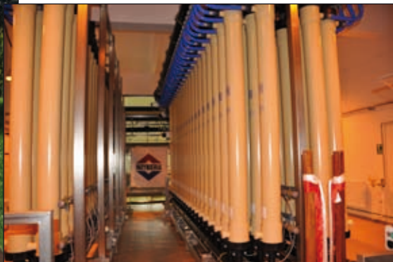
Filtry membranowe w Zakładzie Uzdatniania Wody.
